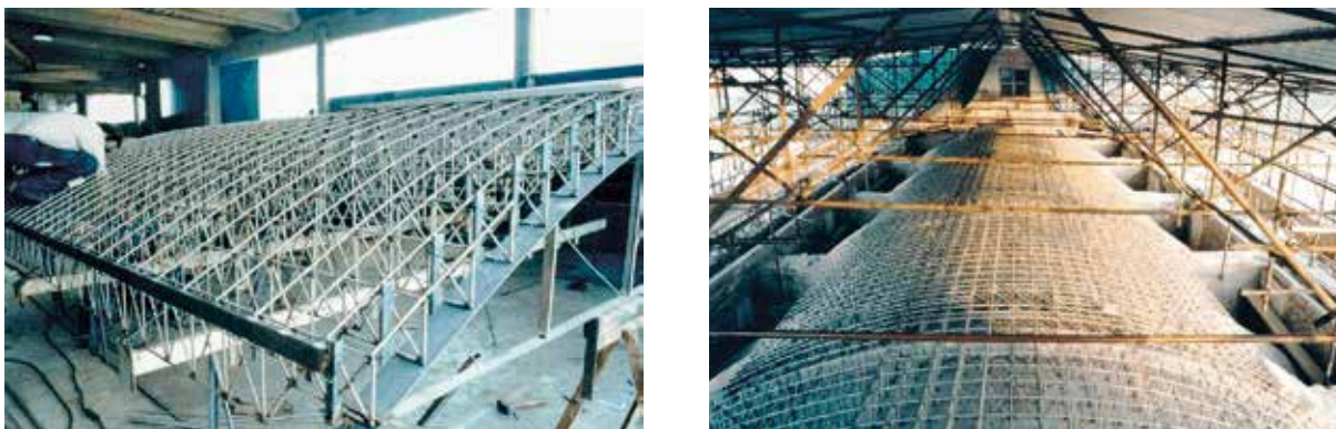
Figura 32. Il Duomo di San Martino a Pietrasanta (LU). Da sinistra: la struttura reticolare spaziale in acciaio inox progettata per il sostegno passivo della volta; vista dell'estradosso della volta rinforzata dalla struttura reticolare.
