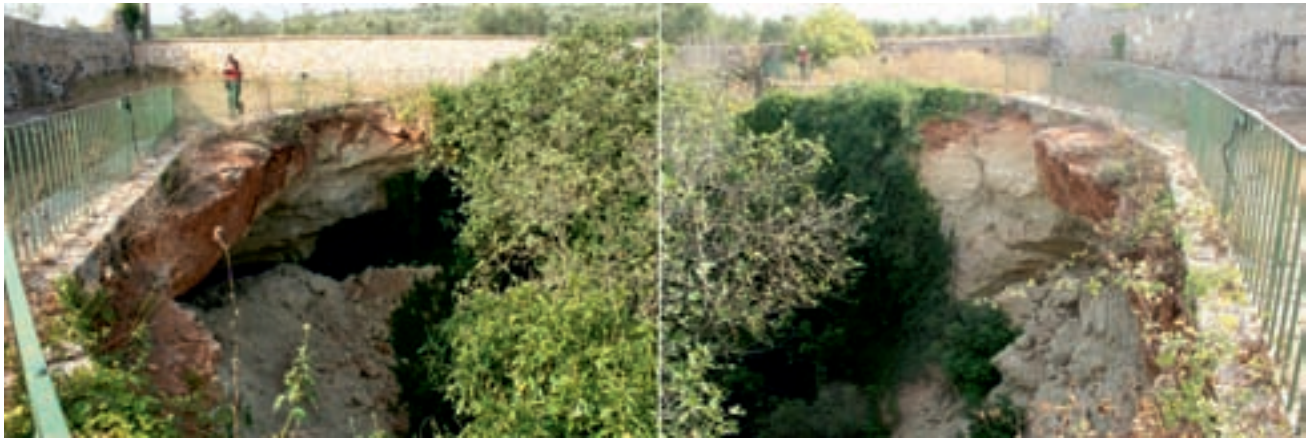
Fig. 4 - Vedute del recente crollo (Febbraio 2011, evento n. 68 in tabella 1) al margine meridionale della Vora Grande di Barbarano (PU 114 nel Catasto delle Grotte Naturali della Puglia; Comune di Morciano di Leuca). - Views of the recent failure (February 2011, event no. 68 in table 1) at the southern edge of Vora Grande di Barbarano (PU 114 in the Register of the Natural Caves of Apulia; Municipality of Morciano di Leuca).
