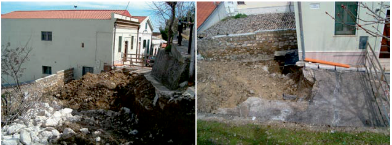
Fig. 5 - Vista complessiva (a sinistra) e particolare (a destra) dello sprofondamento avvenuto a Candela nell'aprile 2006 (evento n. 40 in tabella 1), a causa del crollo della volta di una cantina-deposito. - Overall view (left) and close-up (right) of the sinkhole that occurred at Candela in April 2006 (event no. 40 in table 1), due to fall of the vault of a storage room.
