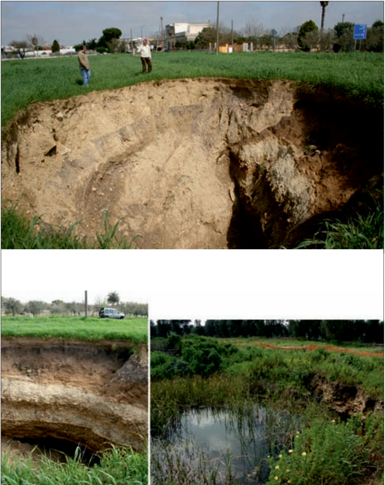
Fig. 10 - Eventi di sprofondamento a Cutrofiano connessi alla presenza di cave sotterranee di calcarenite: a sinistra e in alto, lo sprofondamento del Maggio 2010 (evento n. 58 in tabella 1); da notare la prossimità dello sprofondamento alla Strada Provinciale. A destra, un antico sprofondamento attualmente con presenza di acqua.
