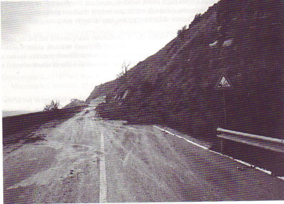
Foto 12.2. Fenomeni franosi superficiali lungo la SS 106 nei pressi di Capo Bruzzano (Foto: O. PETRUCCI).
