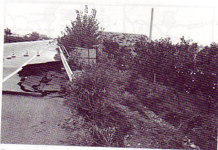
Foto 6.1. Tratto della SS 106 nei pressi di Torricella danneggiato dalle acque del torrente Leccalardo (foto: T. MERCURI).
