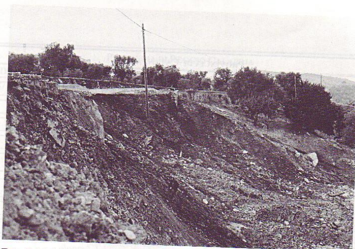
Foto 7.4. Frana lungo la SS 106 nei pressi di Roseto capo Spulico (foto: T. MERCURI).
