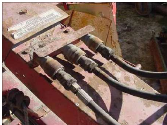
Esempio di tubi idraulici non protetti
