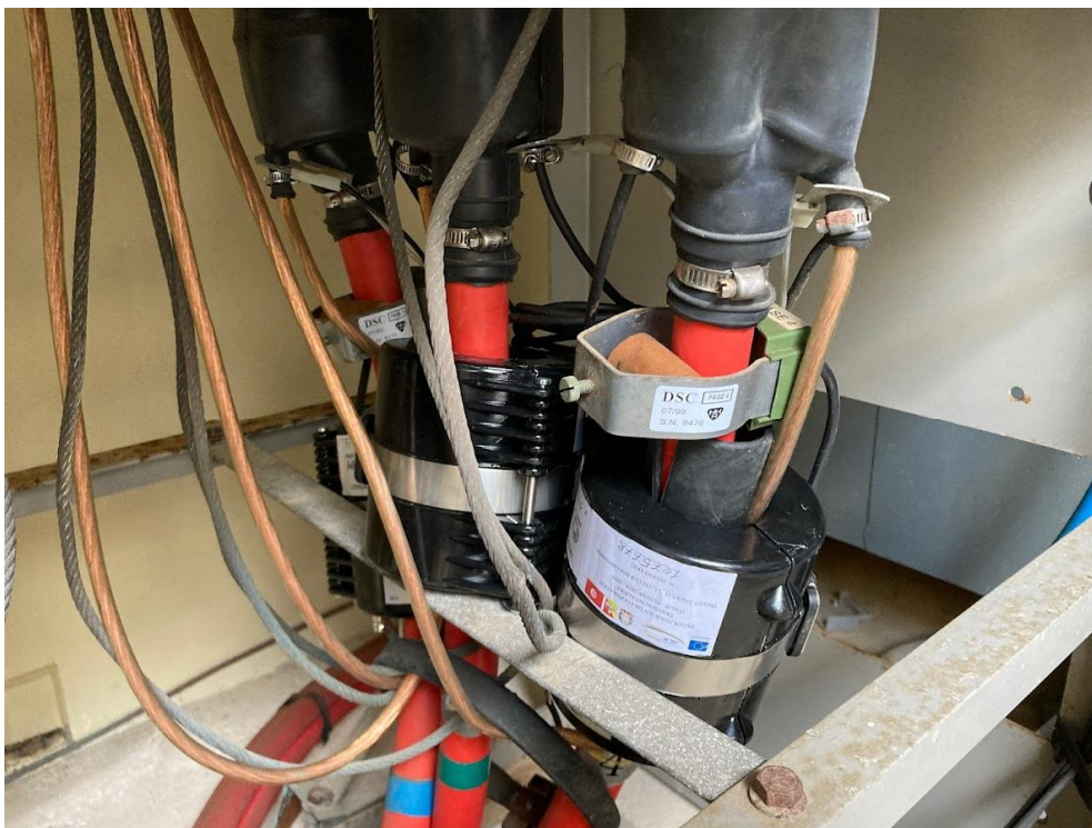
Figura 38 Accoppiatori induttivi montati sui cavi MT della cabina cimitero
