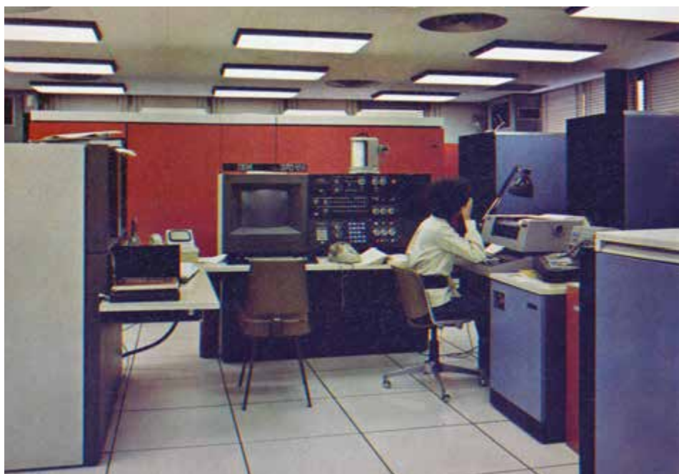
Altro scorcio della sala macchina del CNUCE
