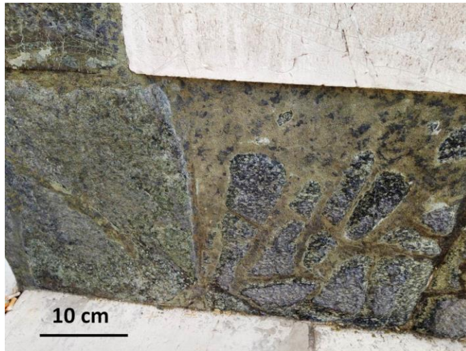
Figure 30. Plastering of a serpentinite ashlar (Church of Santa Maria delle Carceri, Prato)
