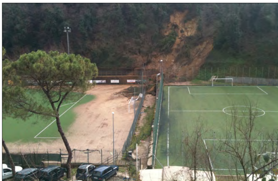
Figura 2. Frana nel campo sportivo del Comune di Riano (RM)
