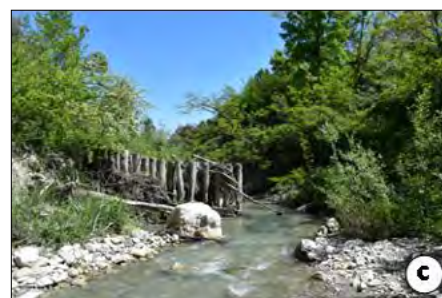
Figura 9. Una briglia realizzata sul Torrente Tiepido (a) nel 1979 (la terza di figura 3) e (b) la ricostruzione dell'ultima della serie crollata nel 2019. Un tentativo di ingegneria naturalistica, (c) dove sono stati utilizzati materiali naturali in sostituzione del calcestruzzo, senza tener conto che anche i criteri progettuali dovevano essere diversi, con evidenti risultati negativi
