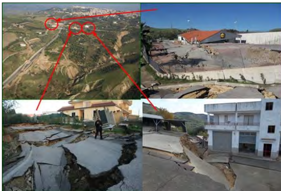
Figura 3. Vista aerea della frana e danni ad alcune strutture della zona
