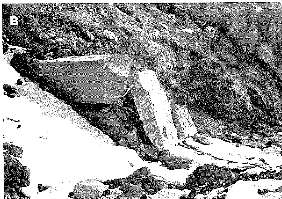
FIG. 10 - Progressione dei dissesti in corrispondenza dell'ala sinistra di una briglia: A) estate 1981; B) ottobre 1981 (Foto FENTI).
