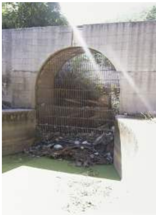
Foto 1 Griglia installata in corrispondenza dell'inghiottitoio della bocca del Dragone – Volturara Irpina (Av)
