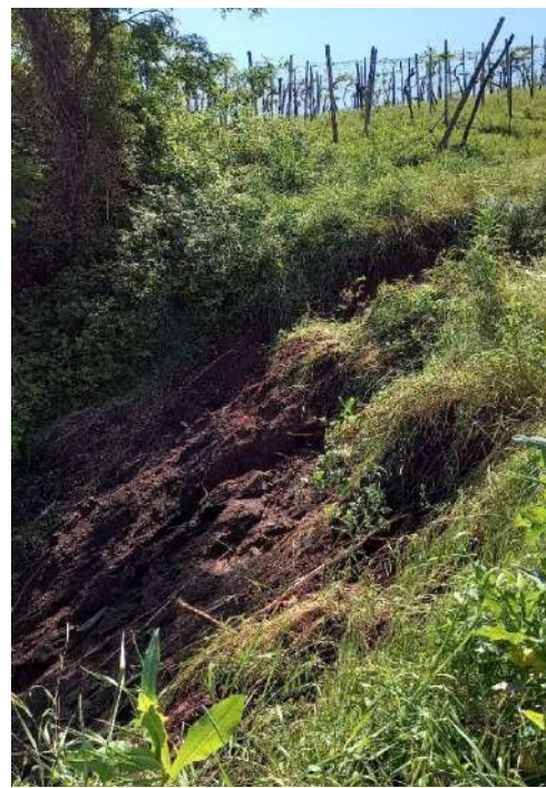
Fig.3.2.24: scivolamento traslazionale sul sentiero tra la zona A e la zona B.
