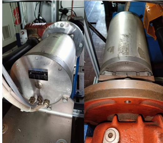
Figura 2 - Motore Elettrico Trifase Ansaldo
