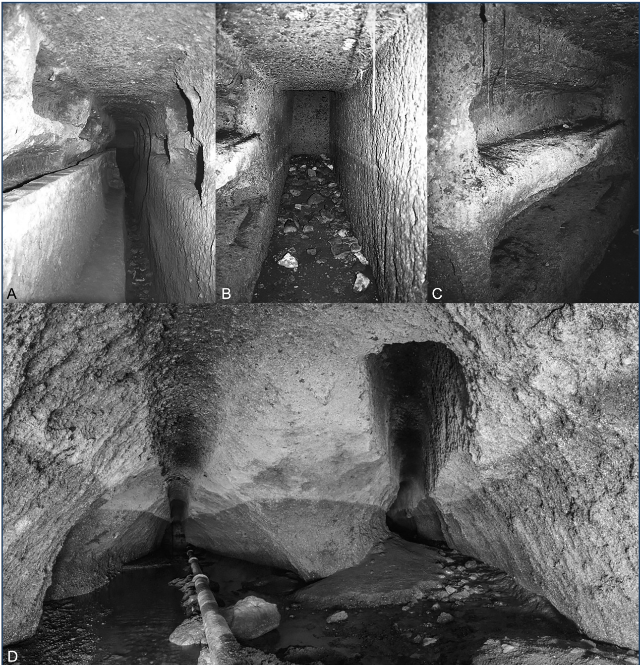
Fig. 4: L'interno del complesso idraulico delle Grotte del Riello (cortesia Ing. L. Proietti).
