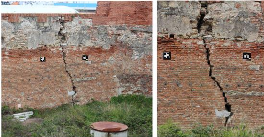
Figura 2- Difetto strutturale di grosse dimensioni presente su una delle pareti a nord della Fortezza Vecchia. Simulazione di posa marker ArUco
