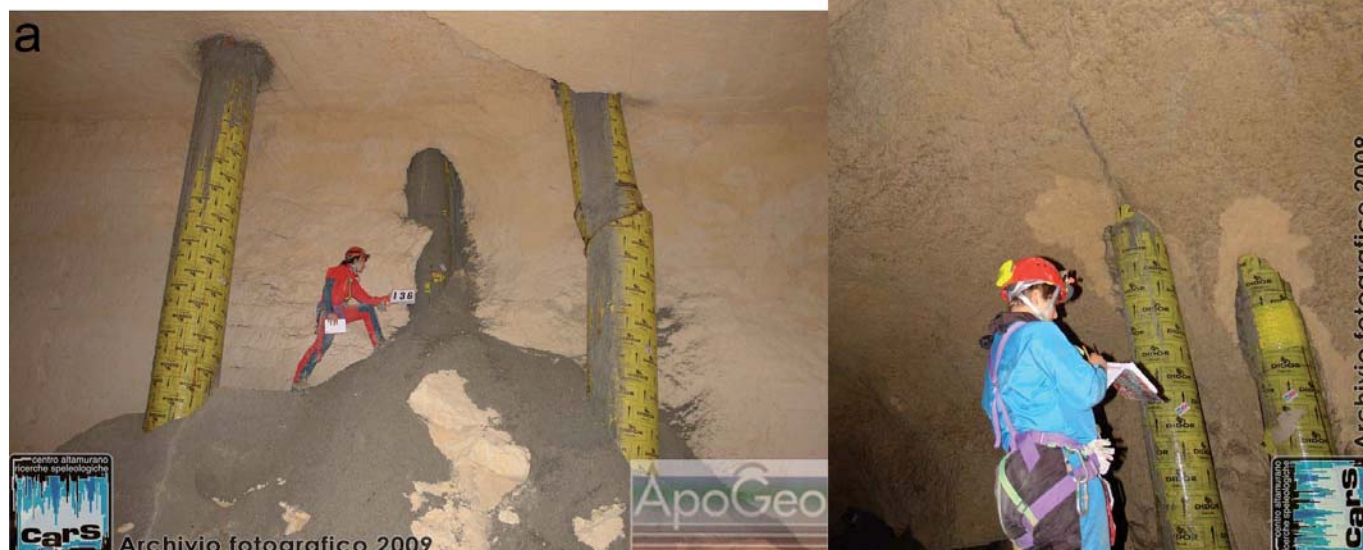
Figura 1 – Pali di fondazione all'interno di cave sotterranee ad Altamura (foto: archivio CARS-Apogeo). Da notare, nella foto b), la frattura in volta, presumibilmente causata dalla realizzazione del palo.
