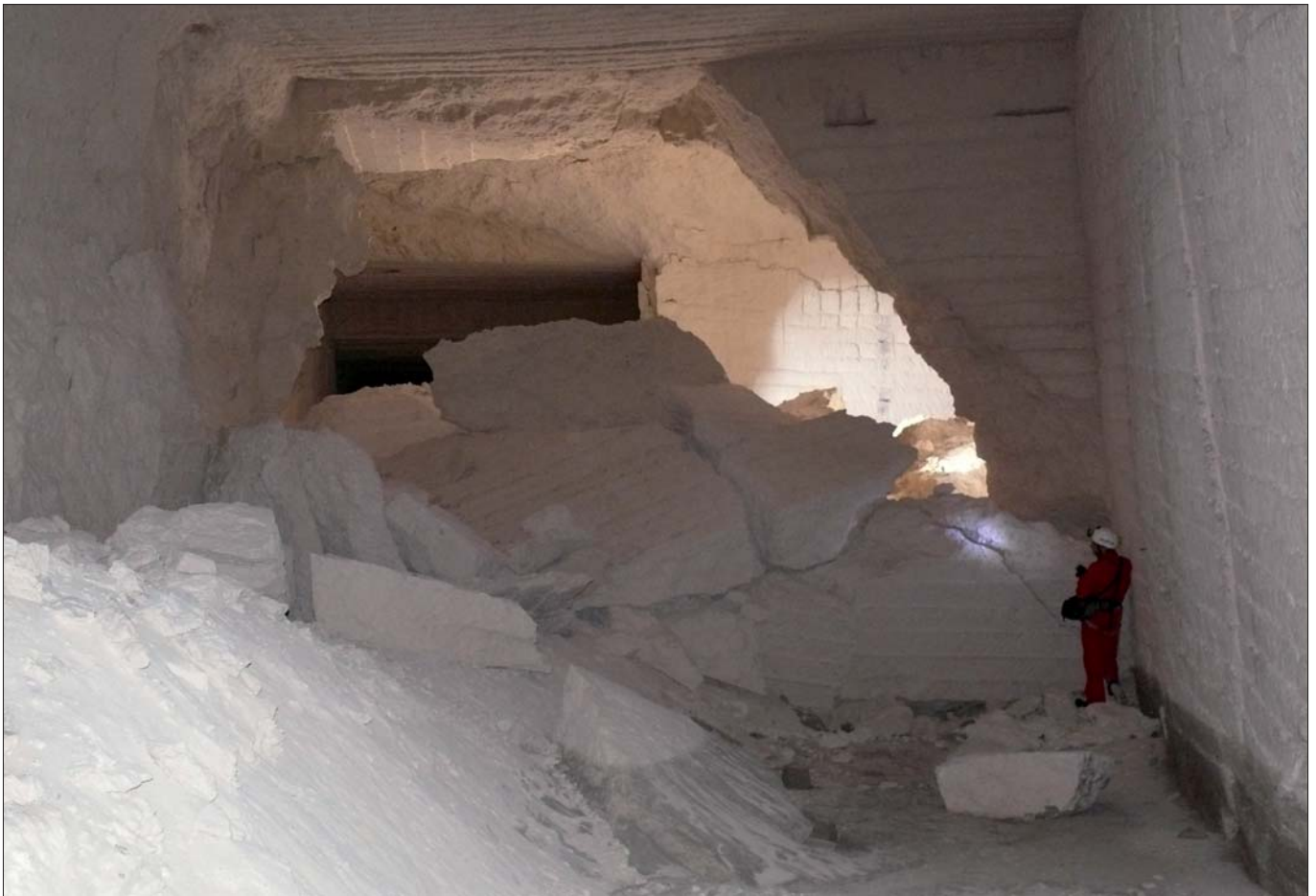
Figura 2 – Crollo di una parete divisoria tra ambienti di cava sotterranea a Cutrofiano, in provincia di Lecce.
