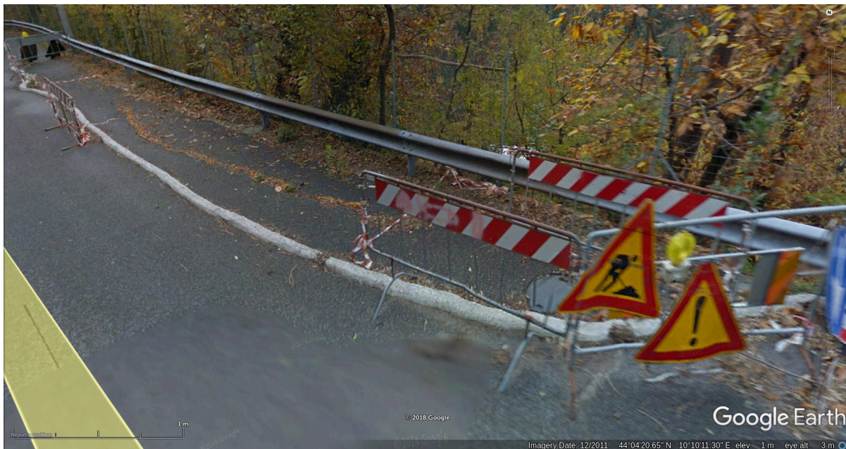
Figura 15: strada dissestata dopo gli smottamenti del terreno. La fotografia rappresenta lo stato dei luoghi nel 2011. Si ringrazia Google per l'uso di questa immagine.
