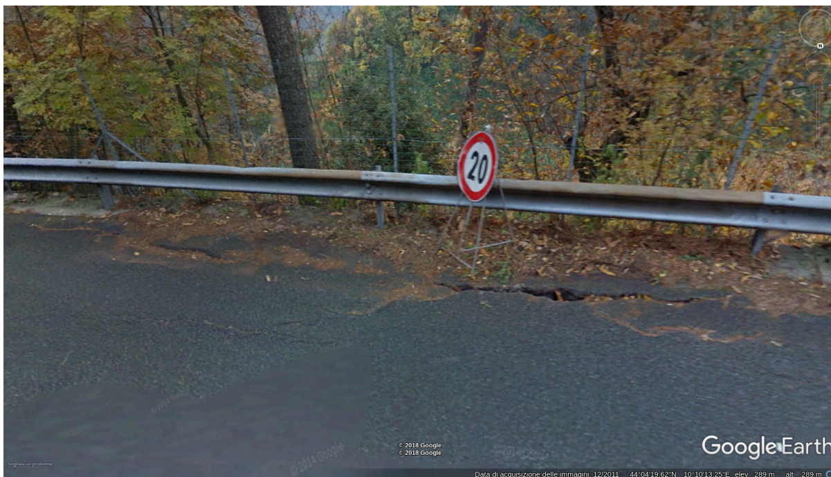
Figura 16: strada dissestata dopo gli smottamenti del terreno. La fotografia rappresenta lo stato dei luoghi nel 2011. Si ringrazia Google per l'uso di questa immagine.
