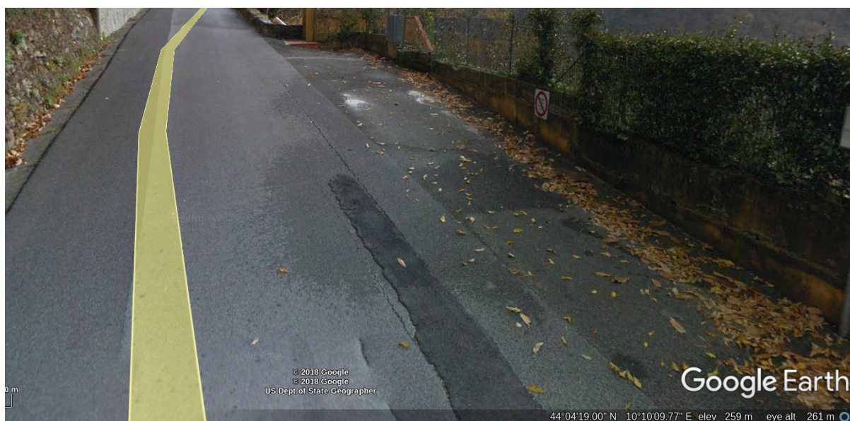
Figura 7: strada dissestata dopo gli smottamenti del terreno. La fotografia rappresenta lo stato dei luoghi nel 2011. Si ringrazia Google per l’uso di questa immagine.
