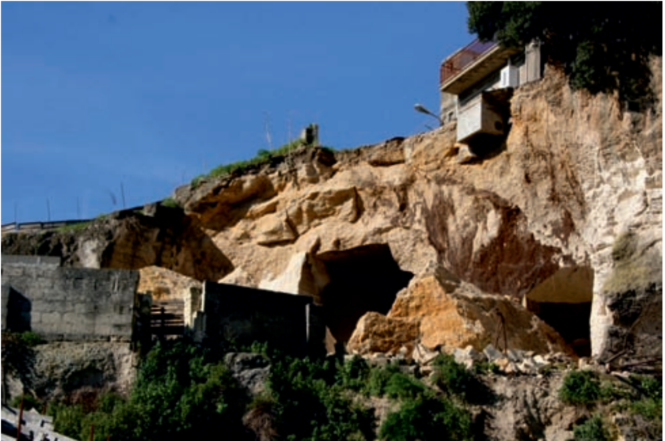
Fig. 3 - Il crollo della zona di accesso a una cava sotterranea presso Ginosa di Puglia ha tranciato parte della sede stradale e minacciato la palazzina visibile al margine destro della fotografia.
