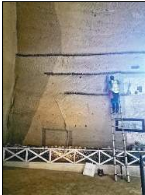
Figura 3.17: Ispezione visiva delle lesioni
