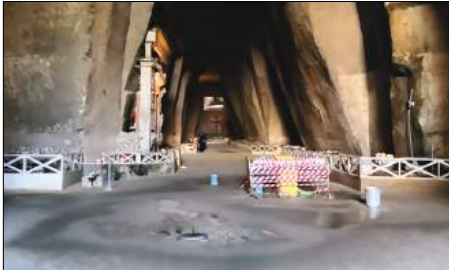
Figura 5.2: Infiltrazioni d'acqua nella navata centrale del Cimitero delle Fontanelle Fonte: Foto dell'Autore, 2020
