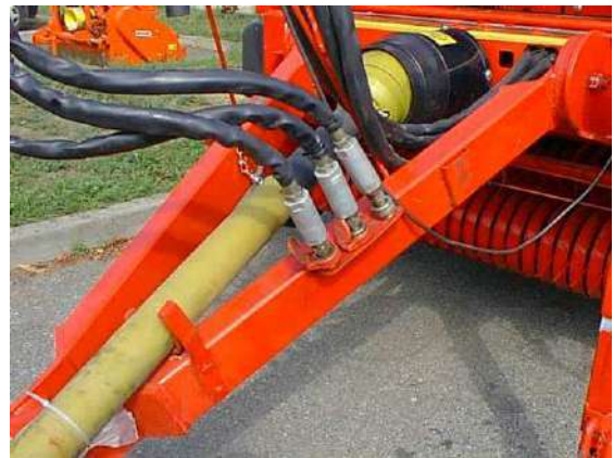
Esempio di tubi idraulici dotati di guaina antiscoppio e correttamente supportati
