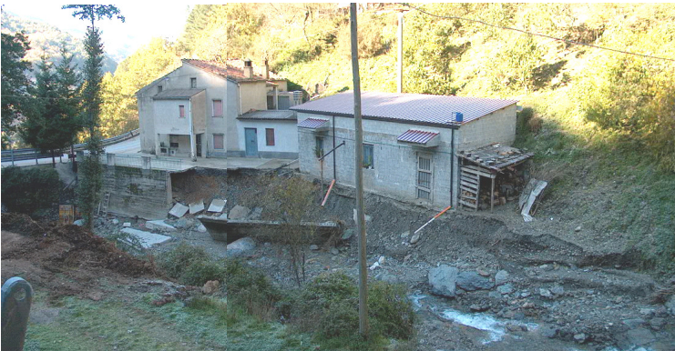
Fig. 6 – Erosione di sponda presso il Ponte Mola, Rogliano (CS) (foto: O. Petrucci).
