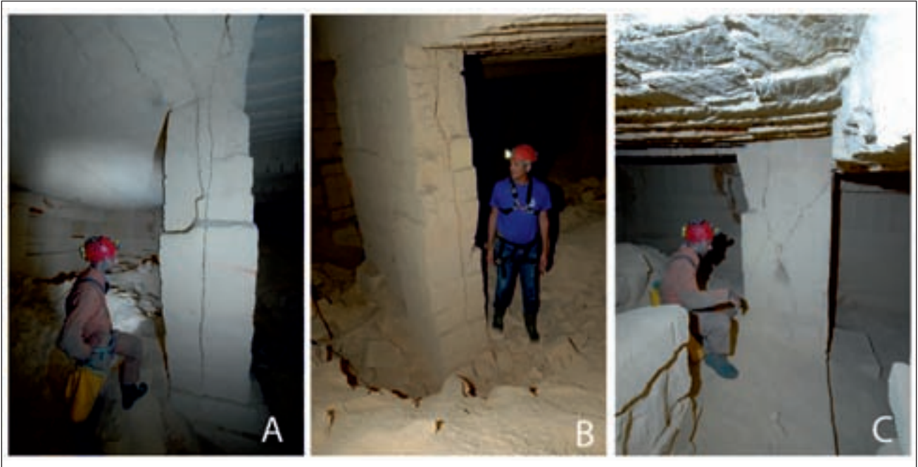
Fig. 5 - A e B - Fratture sub-verticali che sezionano interamente un pilastro della cava. C - pilastro interessato da fratture a diversa inclinazione. - A and B - Sub-vertical joints crossing a quarry pillar. C - pillar affected by joints with varying dip.
