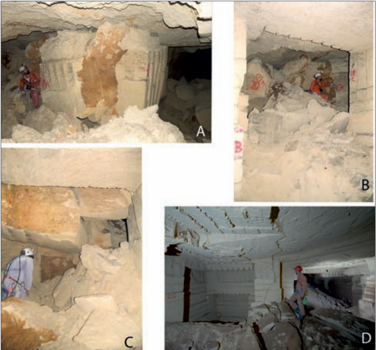
Fig. 3 - Fenomeni di instabilità lungo le volte della cava. Crolli (foto A e B) e movimenti di ingenti volumi di roccia lungo fratture sub-verticali (foto C) rilevati nel 2000, in corrispondenza del settore in cui si è verificato il sinkhole. D - Distacchi di lastre rocciose lungo sistemi di discontinuità paralleli e/o coincidenti ai piani di stratificazione.
