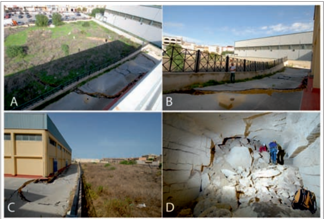
Fig. 6 - A - Sinkhole creatosi nel giugno 2011. B e C - Danni provocati dallo sprofondamento ai manufatti sovrastanti. D - Materiale di crollo presente all'interno della cava in prossimità dell'area interessata dal sinkhole. - A - Sinkhole formed in June 2011. B and C - Damage caused by the sinkhole to the overlying buildings. D - Fall deposits within the quarry in the proximity of the area affected by the sinkhole.
