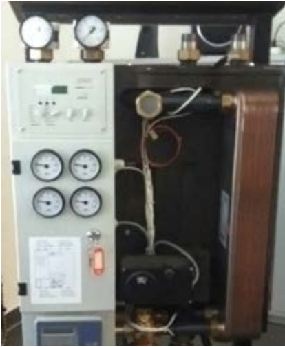
Figura 5. centralina di trasferimento del calore.
