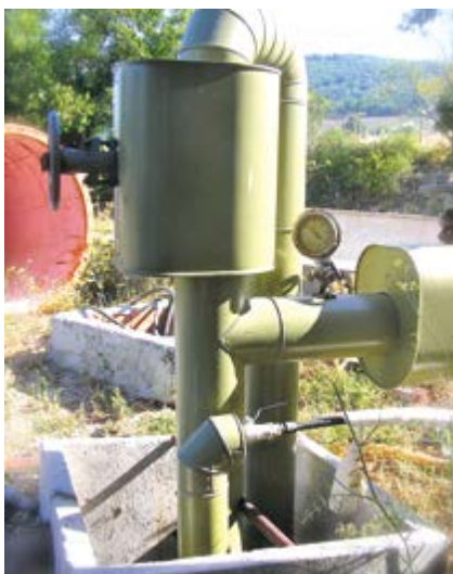
Figura 4. Impianto esterno con tubature di invio (fredda, tubo in basso) e ritorno (calda, tubo in alto orizzontale, con misuratore di temperatura) dell'acqua potabile.
