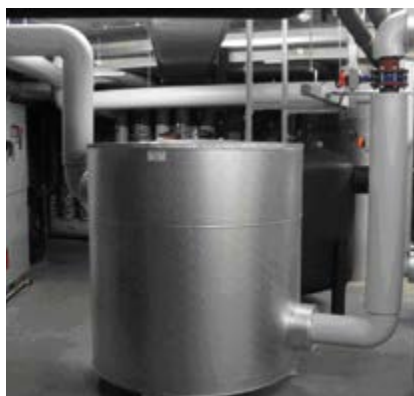
Figura 8. Serbatoio in cui viene immagazzinata l'acqua calda in uscita dalla pompa di calore, per essere poi utilizzata quando richiesto dalle utenze.
