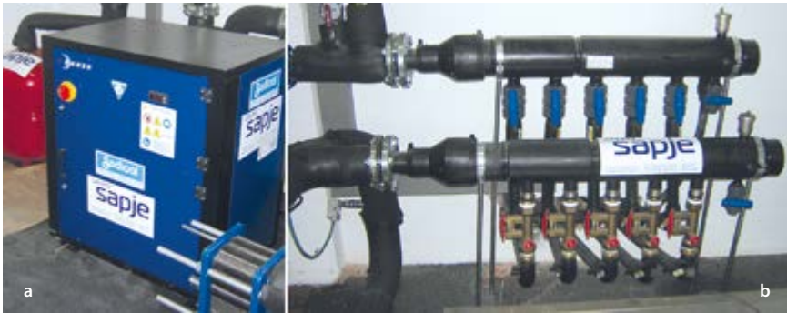
Figura 4. (a) Pompa di calore e (b) collettori collegati alle cinque sonde geotermiche.
