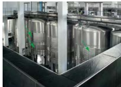
Figura 5. I tini: le frecce verdi indicano le doppie camicie di refrigerazione/riscaldamento utilizzate per il controllo della temperatura.
